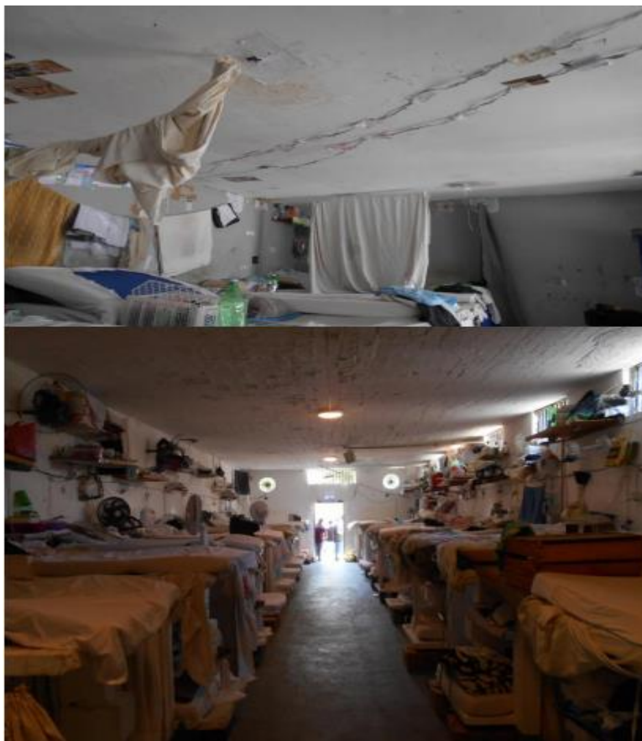
FIGURA 2: “GAMBIARRAS” ELÉTRICAS ATRAVESSANDO O TETO E NO DETALHE UMA CELA COLETIVA
